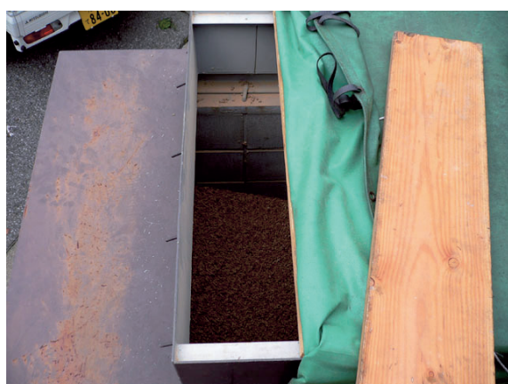
サイロ上部のペレット投入口
