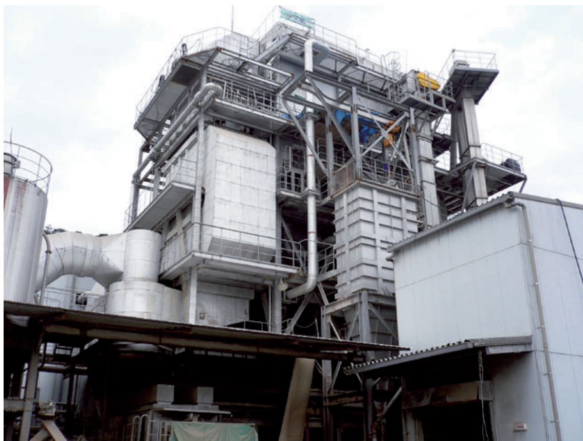
ボイラ・発電設備全景
