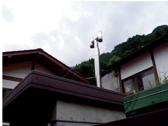
ペレットボイラの煙突
