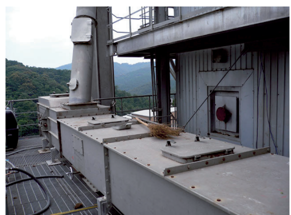
ボイラへの鶏糞搬送路
