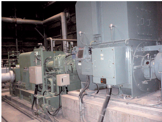
蒸気タービン・発電装置
