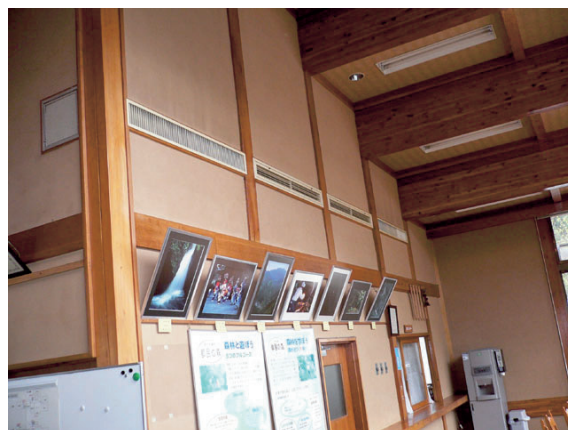
館内の暖房吹き出し口
